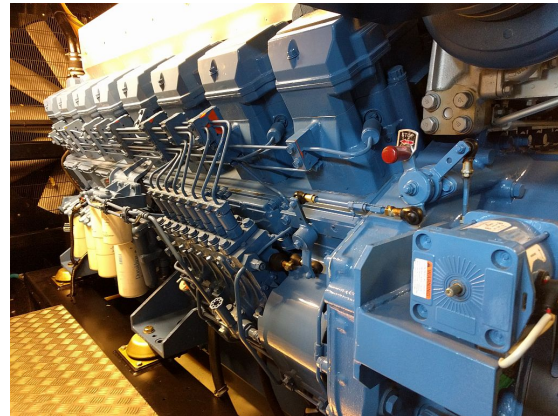
Nødgenerator G3 på 1900 kVA (foto: Per Nørgård, 2018).
