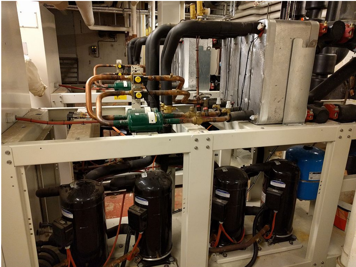
Køleanlægget til ekstra køling af søvandet består af to ens anlæg, hver med 4 kølekompressor og varmevekslere mellem søvandet og det centrale kølesystem. (Foto: Per Nørgård, DTU, 2018)
