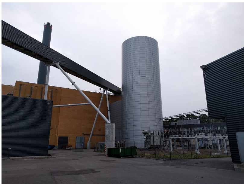
RVV's termiske lagertank i Rønne (foto: Per Nørgård, 2018).
