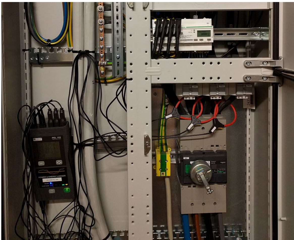
Måling af kølekompressores elforbrug på Bornholms Hospital (foto: Per Nørgård, 2018).
